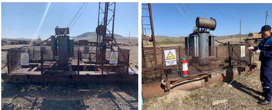
Зураг 31. Засварын талбайн өндөр хүчдэлийн трансформаторын гадна талын торон хашаанд ХАБ-ын шаардлагын дагуу АНХААРУУЛАХ ПЛАКАД -нуудыг дөрвөн талд нь байршуулж, цахилгаан хүчдэлд нэрвэгдэх эрсдэлийг бууруулж ажилласан.
