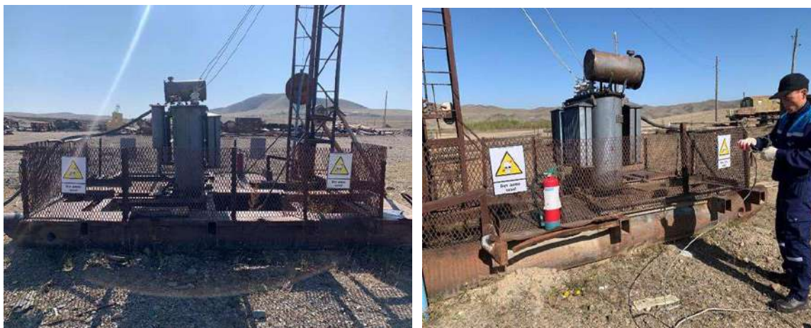
Зураг 36. Засварын талбайн өндөр хүчдэлийн трансформаторын гадна талын торон хашаанд ХАБ-ын шаардлагын дагуу АНХААРУУЛАХ ПЛАКАД -нуудыг дөрвөн талд нь байршуулж, цахилгаан хүчдэлд нэрвэгдэх эрсдэлийг бууруулж ажилласан.
