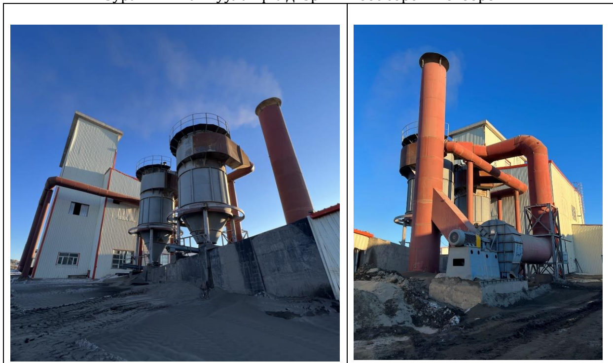
Зураг №7. Баяжуулах үйлдвэрийн тоос сорогч төхөөрөмж
