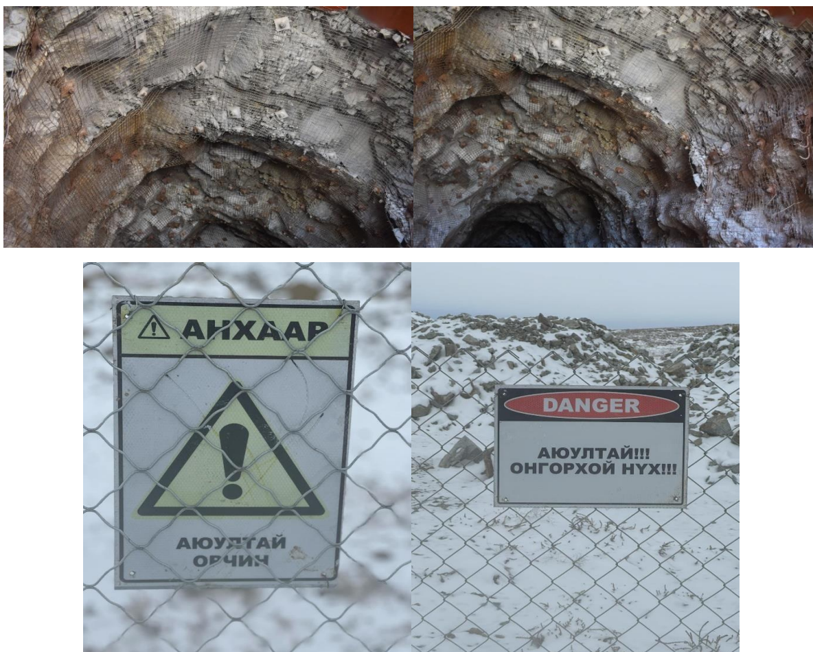
Зураг 3: Онон судлын Төмөр торон бэхэлгээ болон гадарга дээр цөмрөлт үүссэн газрыг аюулгүй болгон хашаалсан байдал
