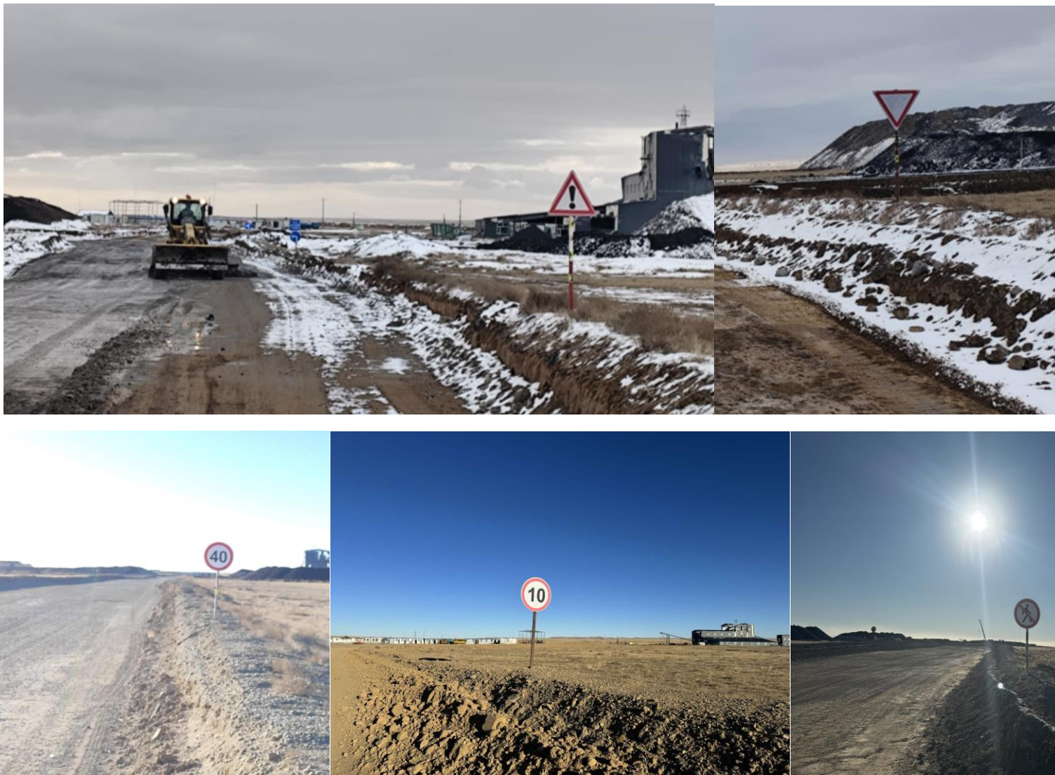
Зураг 6. Замын тэмдэг, тэмдэглэгээ байрлуулсан байдал.
