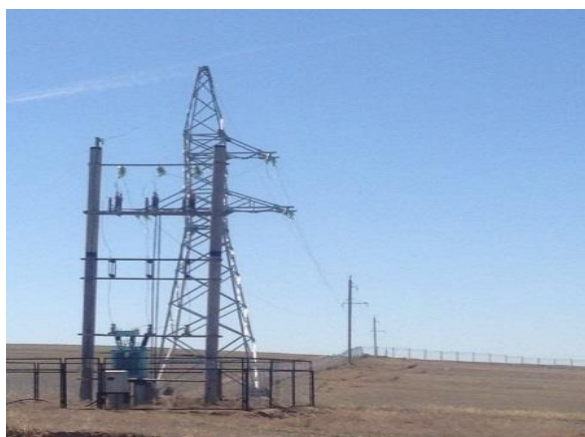
Зураг 12. 35/04 шугамын дэд станц
