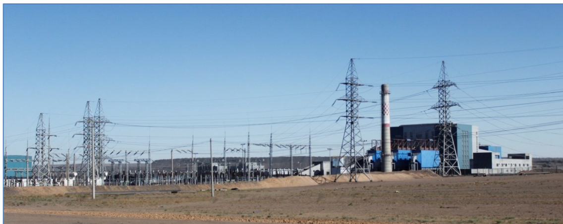
Зураг 1.5. Цахилгаан станц
