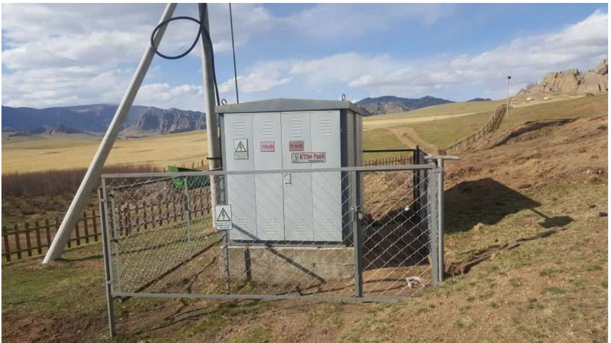
Зураг 8. Цахилгаан үүсгэвэр, нөөцийн генератор
