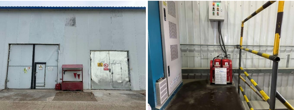
Зураг 27. Галын сараалж болон галын хор байрлуулсан байдал
