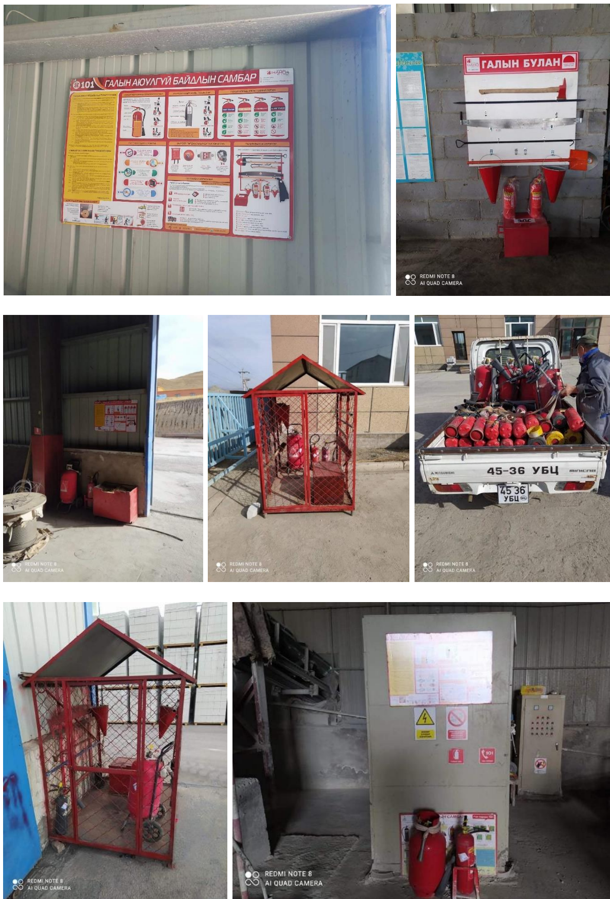
Зураг 26. Гал унтраах зөөврийн болон суурин тоног төхөөрөмж, багаж хэрэгслүүдийг бэлтгэсэн байдал
