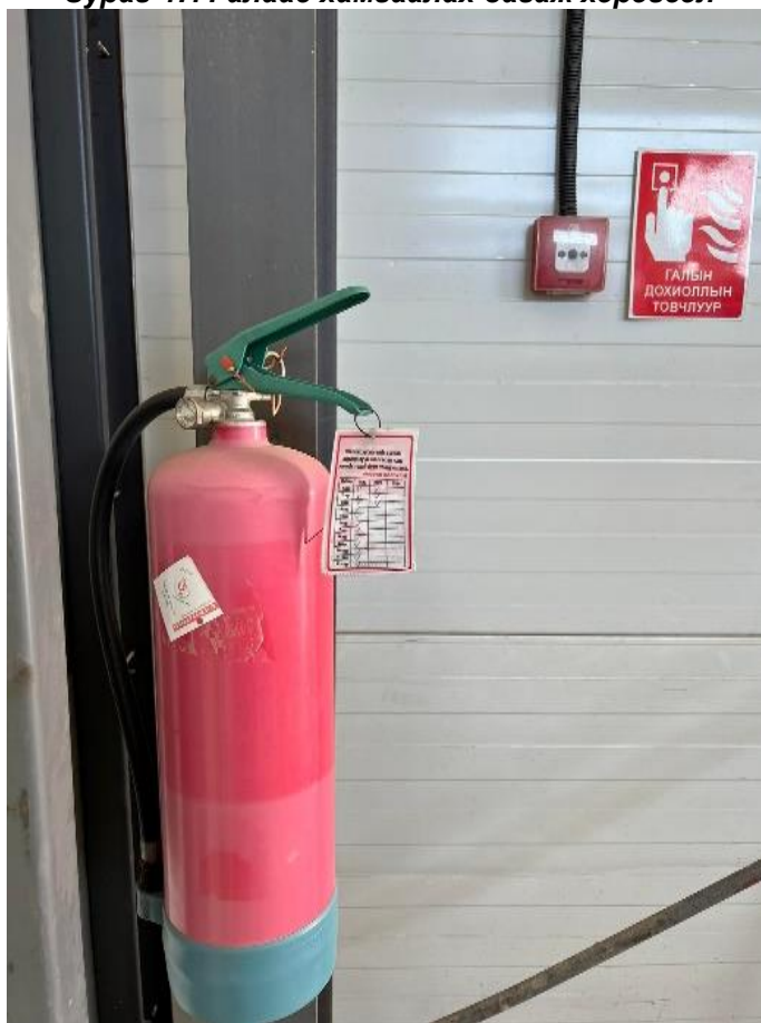
Зураг 48. Үйлдвэр, агуулахад галын хорыг байршуулсан байдал
