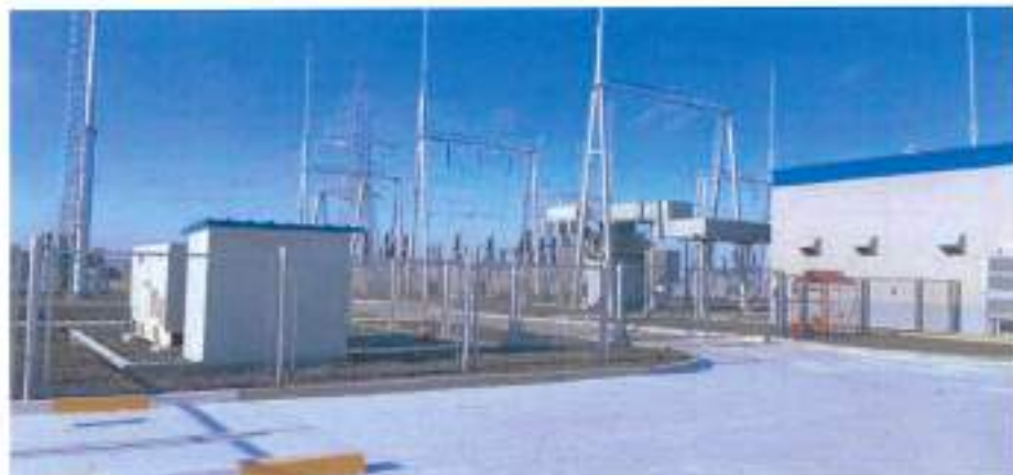
Зураг.3 Дэд станц
