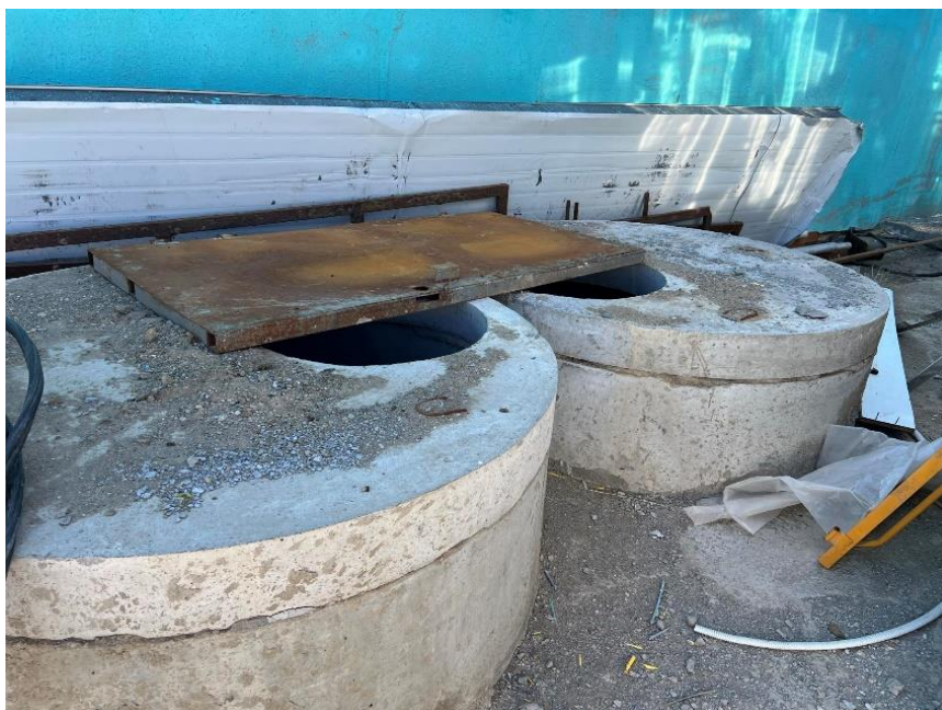
Зураг 11: Үйлдвэрийн ажилчдын хэрэгцээнээс гарах бохир хуримтлуулах цооног
