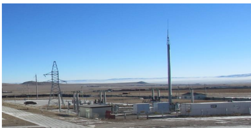
Зураг 3: Цахилгааны 35/0,4 кВ-ын дэд станц
