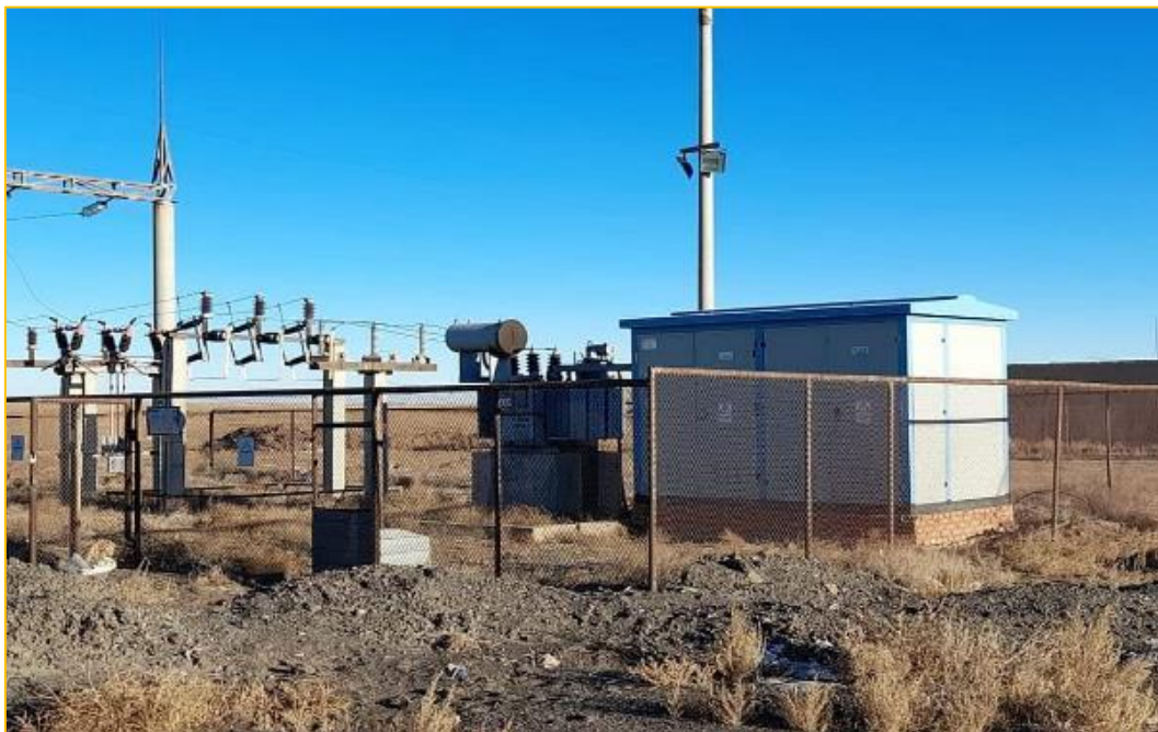
Зураг 5. Үйлдвэрийг ЦЭХ-ээр хангах 35/0.4 кВ-ын дэд станц
