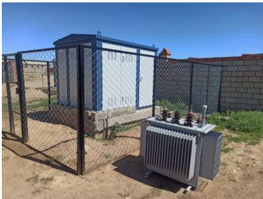
Зураг 8. Үйлдвэрийн талбайд байрлах дэд станц
