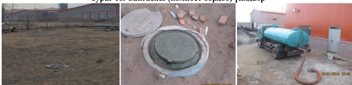
Зураг 17. Хаягдал бохир ус хуримтлуулах сав болон бохирыг соруулж буй байдал
