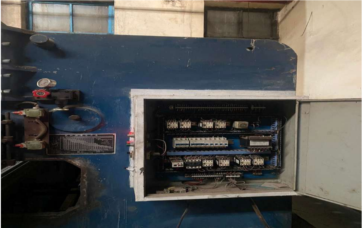
Зураг 8. Төслийн цахилгаан үүсгүүр буюу 380В-ын трансформатор болон галын аюулаас хамгаалах хэрэгсэл
