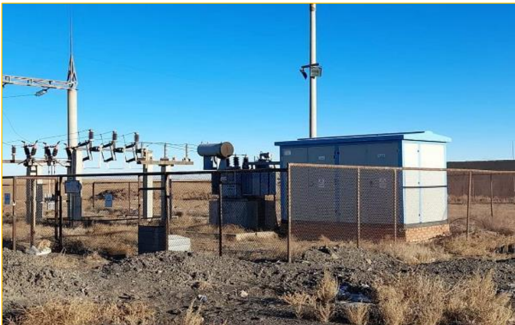
Зураг 5. Үйлдвэрийг ЦЭХ-ээр хангах 35/0.4 кВ-ын дэд станц
