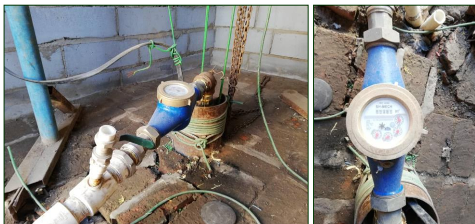
Зураг 5. Унд ахуйн гүний худгийг тоолууржуулсан байдал
