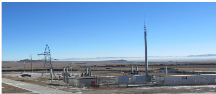
Зураг 3 Цахилгааны 35/0,4 кВ-ын дэд станц
