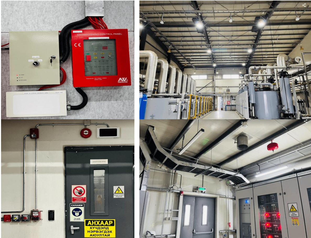
Зураг 3.2 Галын дохиоллын автомат системийг шалгасан байдал
