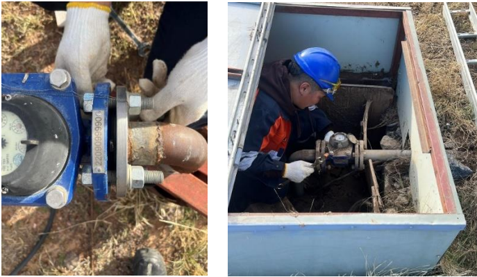
Зураг 8. “Чандмань Илч”ХХК тоолуур суурилуулж буй байдал
