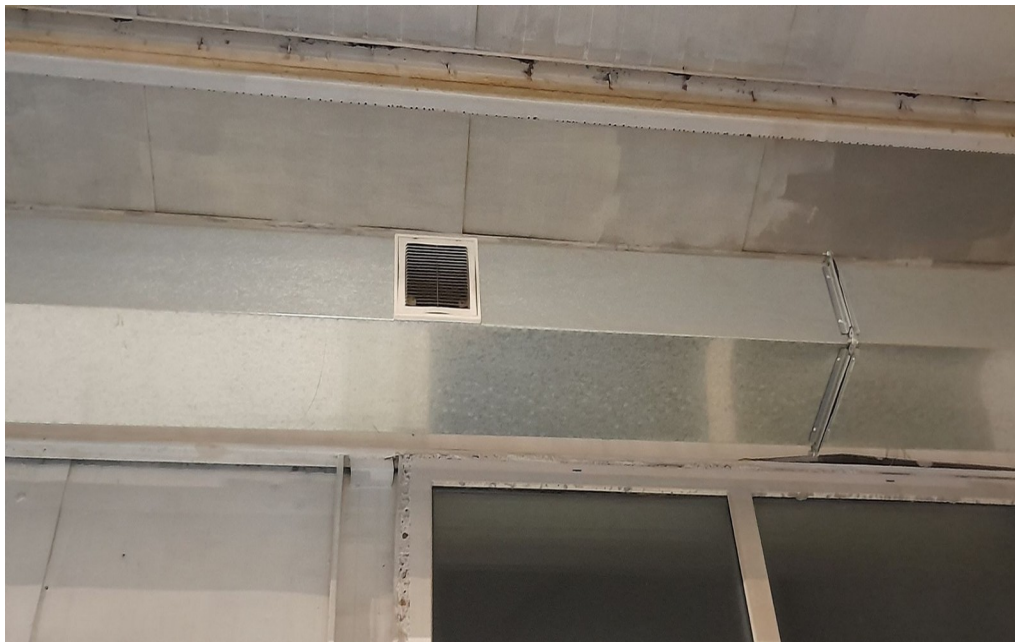
Зураг 26. Ариун цэврийн өрөөнд агааржуулагч сэнс байршуулсан фото зураг
