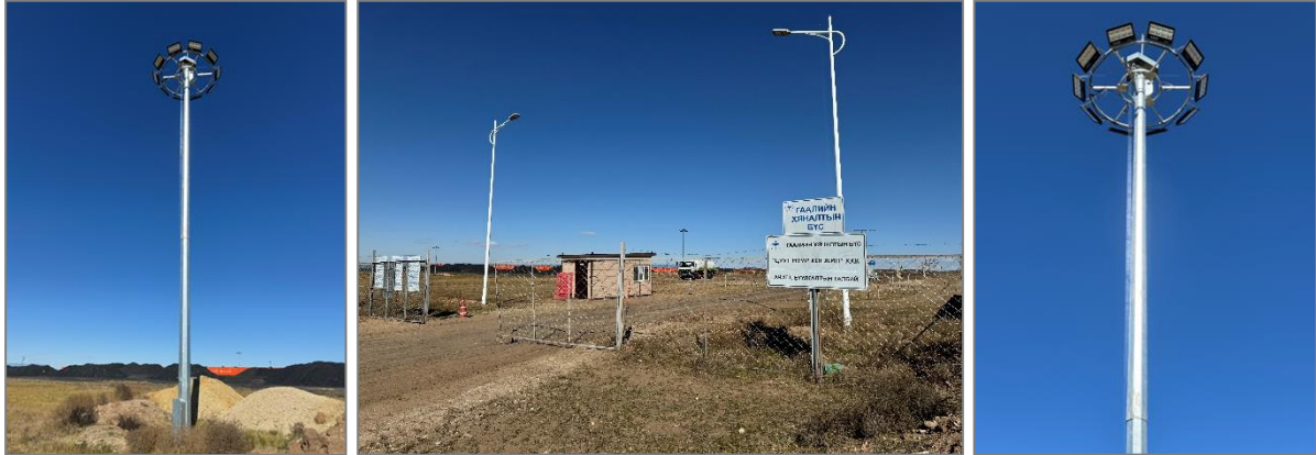
Зураг 32. Төслийн талбайд байршуулсан гэрэлтүүлэг
