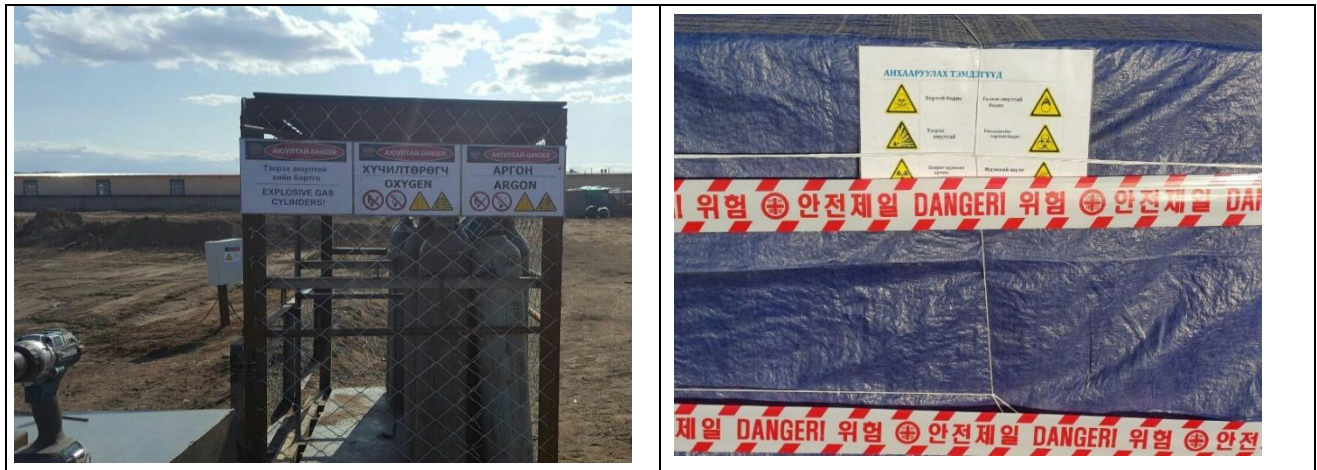
Зураг 11 Химийн хортой бодис болон хийн баллонуудыг зориулалтын хадгалах саванд хийн анхааруулах тэмдэг байршуулсан байдал.
