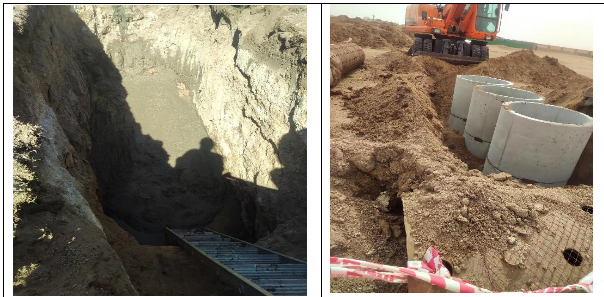
Зураг.3 Төслийн талбай, ахуйн байрны бохирын шийдэл болон ус, шугам хоолой угсарч байгаа нь.
