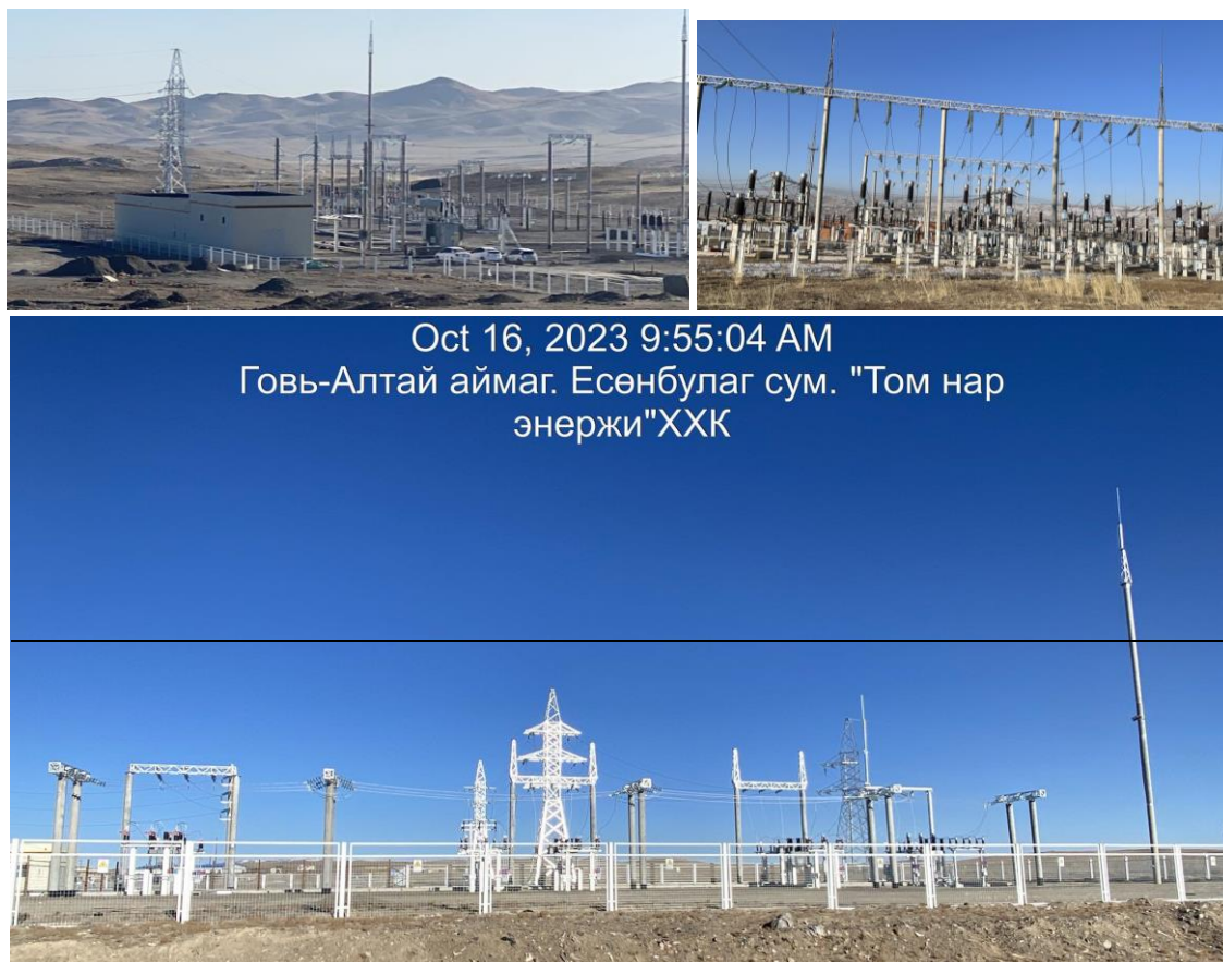
Зураг 2. “Алтай Улиастай эрчим хүчний систем” ТӨХК-ийн “Есөнбулаг” дэд станц, 110/35/6 кВт
