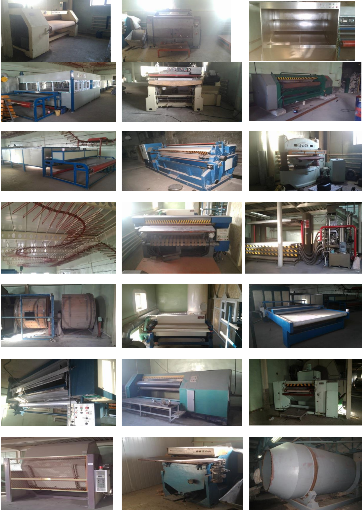
Зураг 8. Арьс шир боловсруулах үйлдвэрийн дотор тал/ шинээр суурилуулсан тоног төхөөрөмжүүд/
