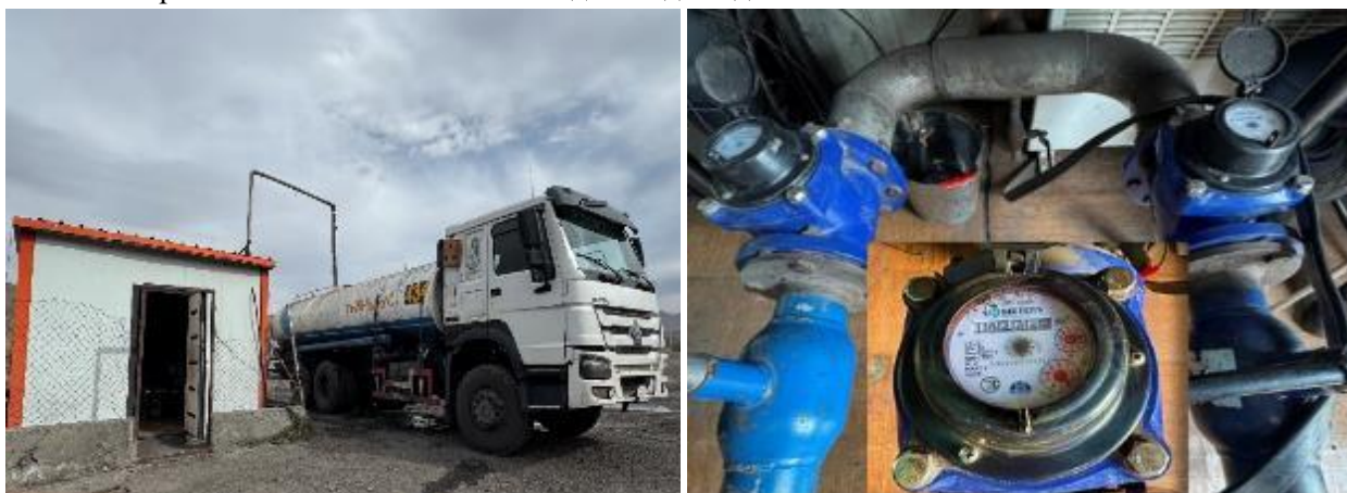
Зураг 4. Well-2 худаг, суурилуулсан усны тоолуур
