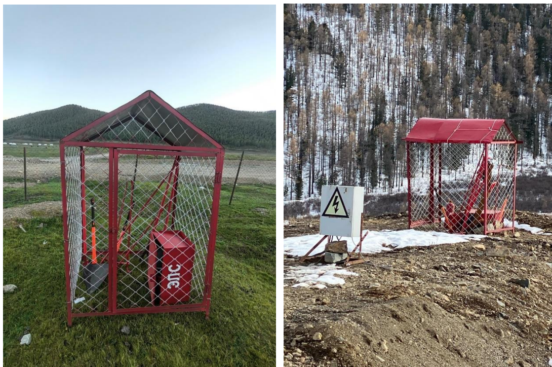
Зураг № 17 Галын сарааг хотхон болон засварын талбайд байршуулсан байдал
