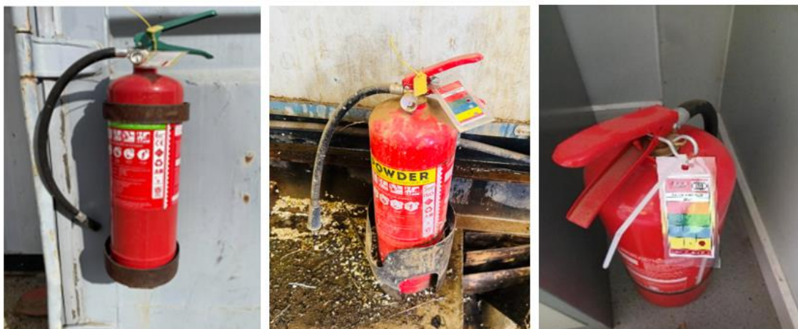
Зураг 44. Галын хор байрлуулсан зураг
