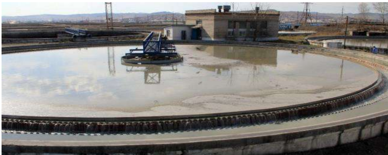
Зураг 24. Ус хангамжийн цех, төв цэвэрлэх байгууламж
