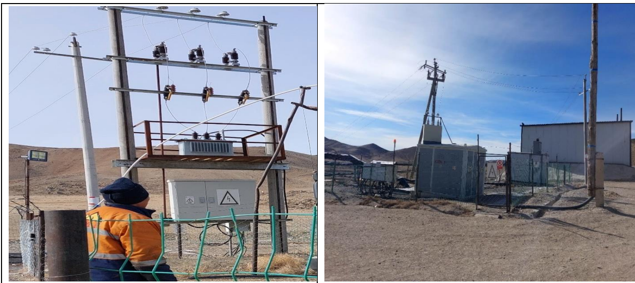
Зураг 19. Дэд станц
