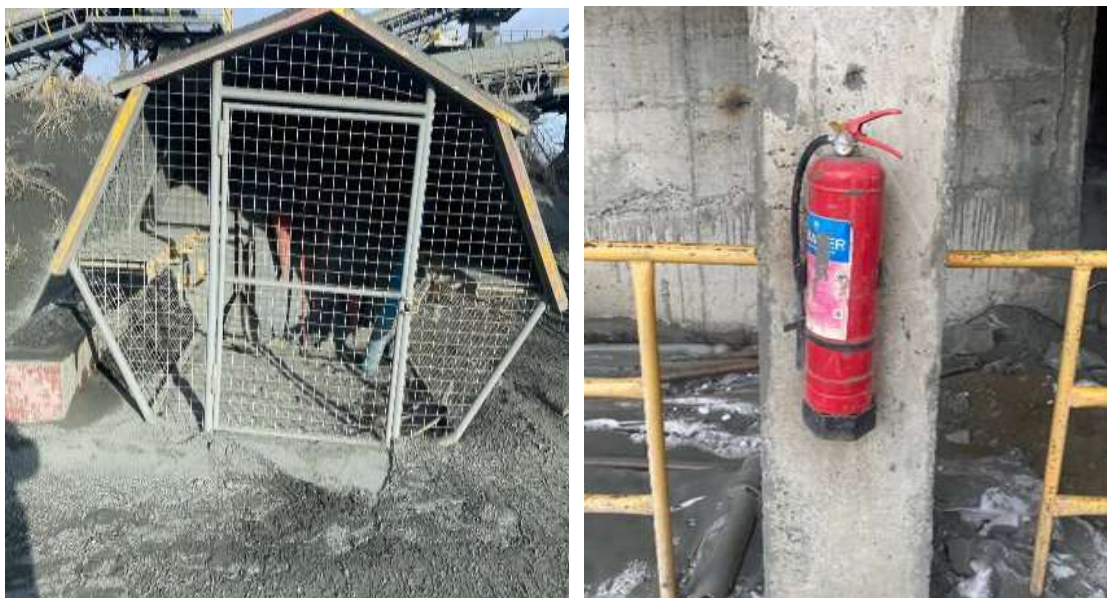
Зураг 7.7: ХБҮ-н гадна байрлуулсан галын сараа, гал унтраагуур
