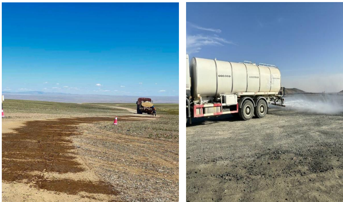
ЗУРАГ 5 ТООСЖИЛТТОЙ ҮЕД ЗАМЫН УСАЛГАГА ХИЙЖ БУЙ БАЙДАЛ
