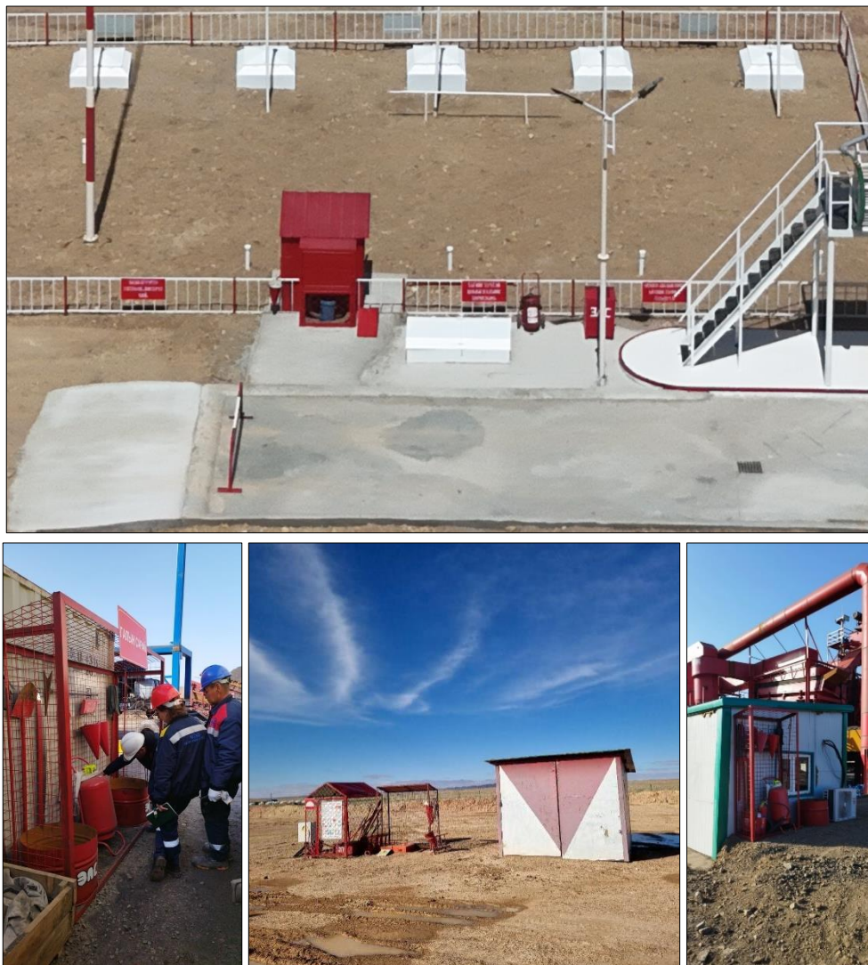
Зураг № 37. Галын сарай, галын хорыг уурхайн обьектуудад байрлуулсан байдал
