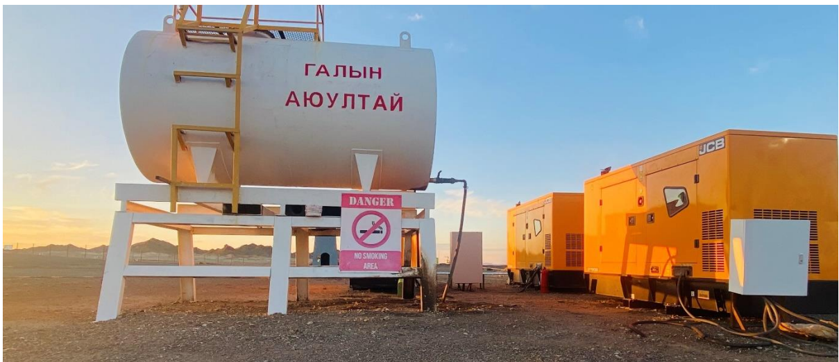
Фото зураг 17. Галын аюулгүй байдлын тэмдэг, тэмдэглэгээ байршуулсан байдал
