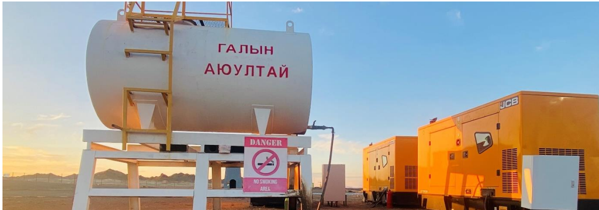
Фото зураг 2. Генераторууд болон түлшний сав
