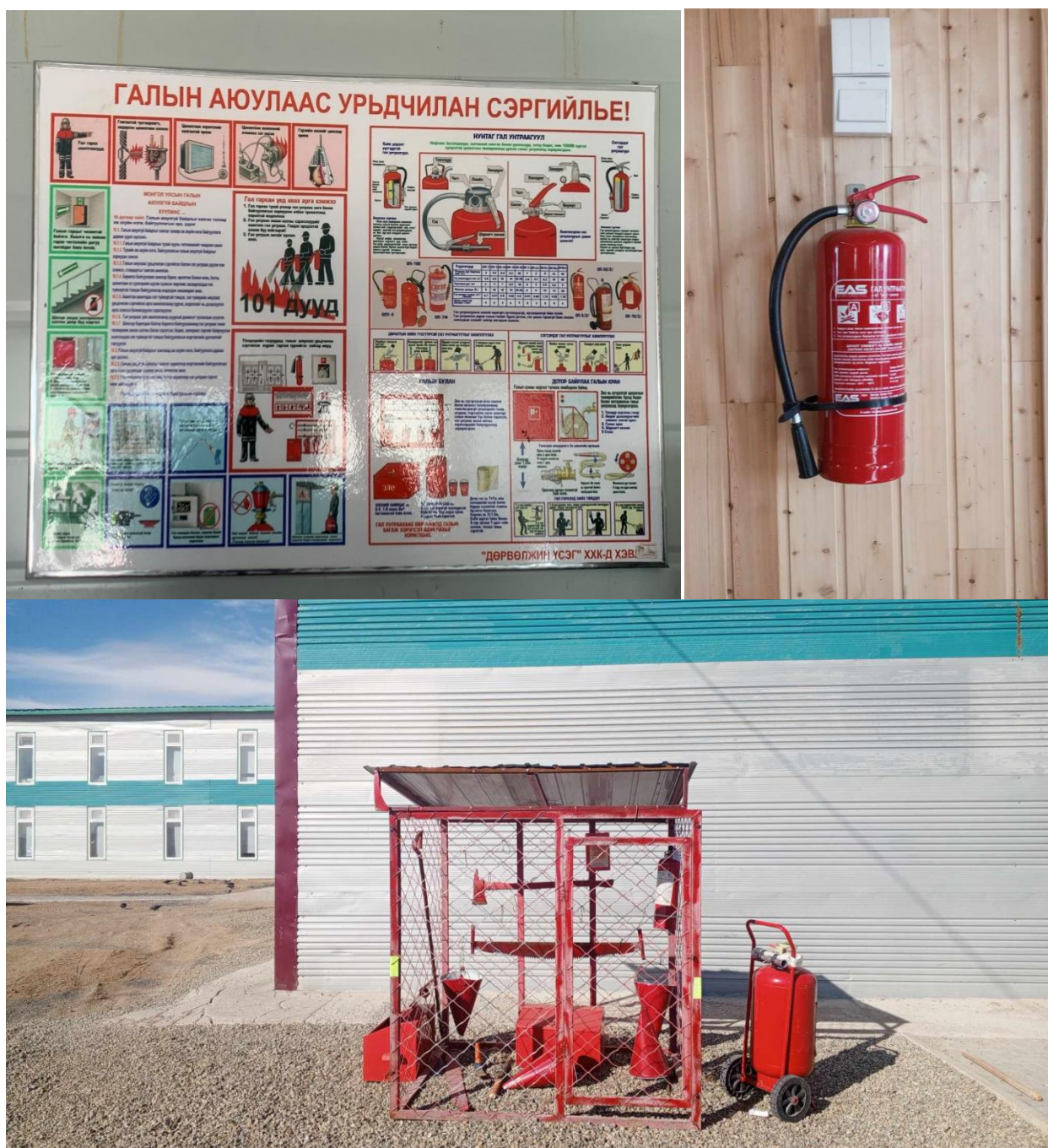
Зураг49. Ажлын байран дээрх гал унтраах багаж
