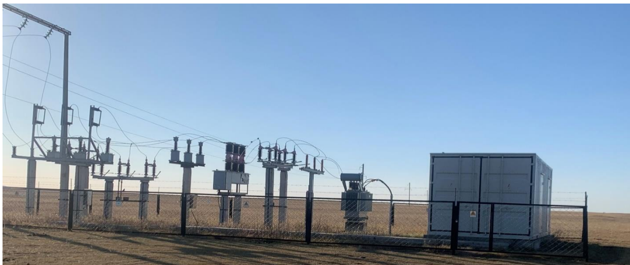
Зураг9. Дэд станц
