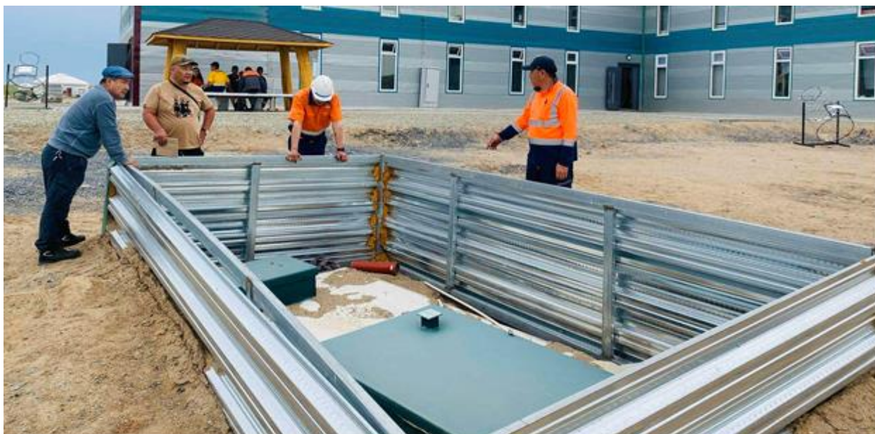
Зураг26. Суурьлуулсан цэвэрлэх байгууламж
