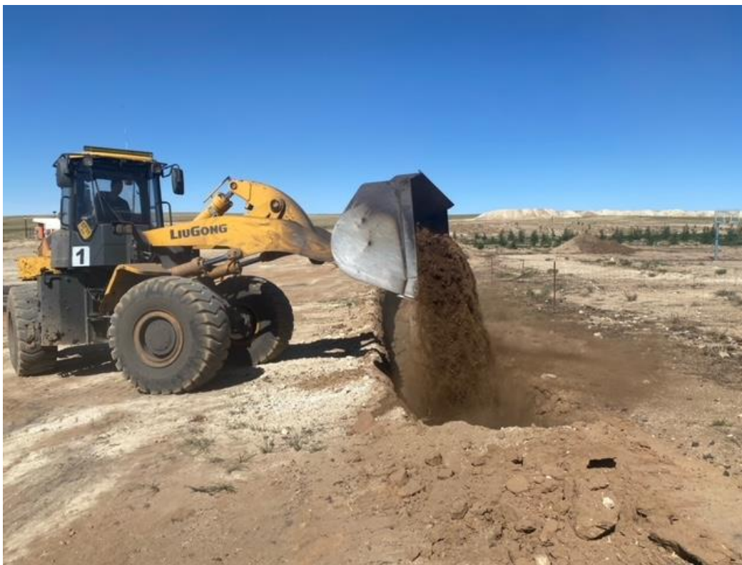
Мод тарих нүхийг экскавотароор ухаж дугуйт ачигчаар бууцтай хольсон шороогоор дүүргэж байгаа нь
