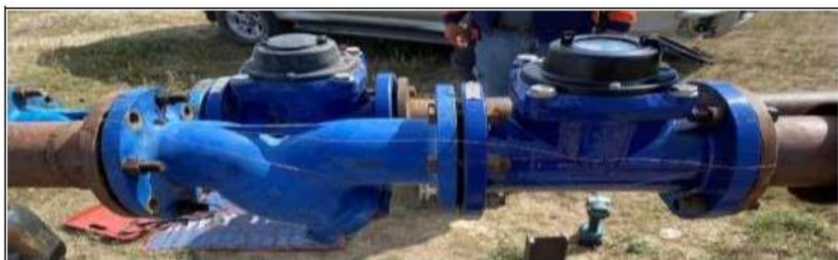
Тоолуур байршуулсан байдал
