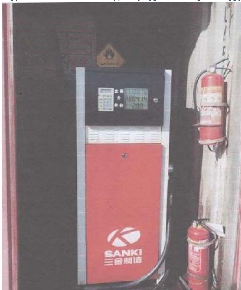
Зураг 22. ШТС-ын талбайд байрлуулсан гал унтгаагуур
