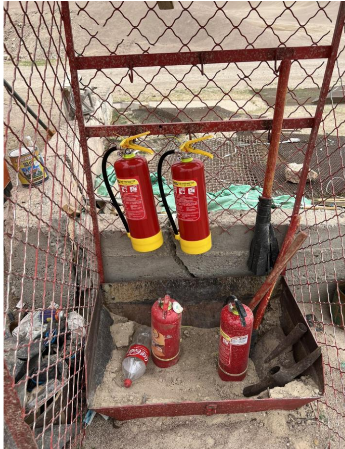
Зураг 7. Галаас сэргийлэх багаж хэрэгсэл байршуулсан байдал
