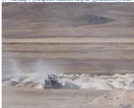
Зураг 18. Уурхайн баруун урд байрлах овоолго бүхий хэсэгт техникийн нөхөн сэргээлт хийж буй байдал
