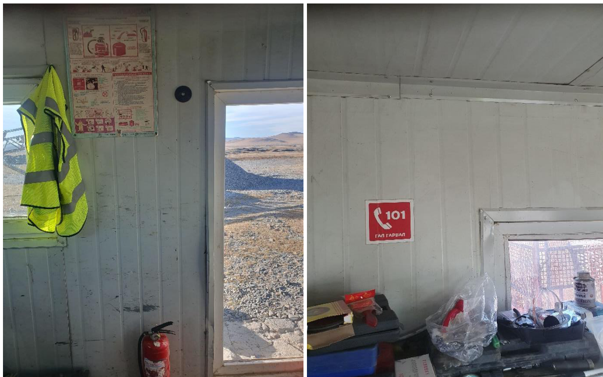
Зураг 14. Галын аюулгүй байдлын самбар, тэмдэгүүд, галын хор байршуулсан байдал
