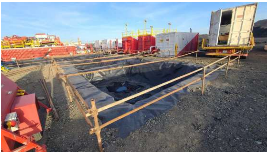
Зураг 54. Өрөмдлөгийн ажлын явцад өрмийн шингэн хуримтлуулах нүхэнд ажилтнууд унаж бэртэхээс хамгаалсан аюулгүйн төмөр хашаа хаалт хийсэн байдал
