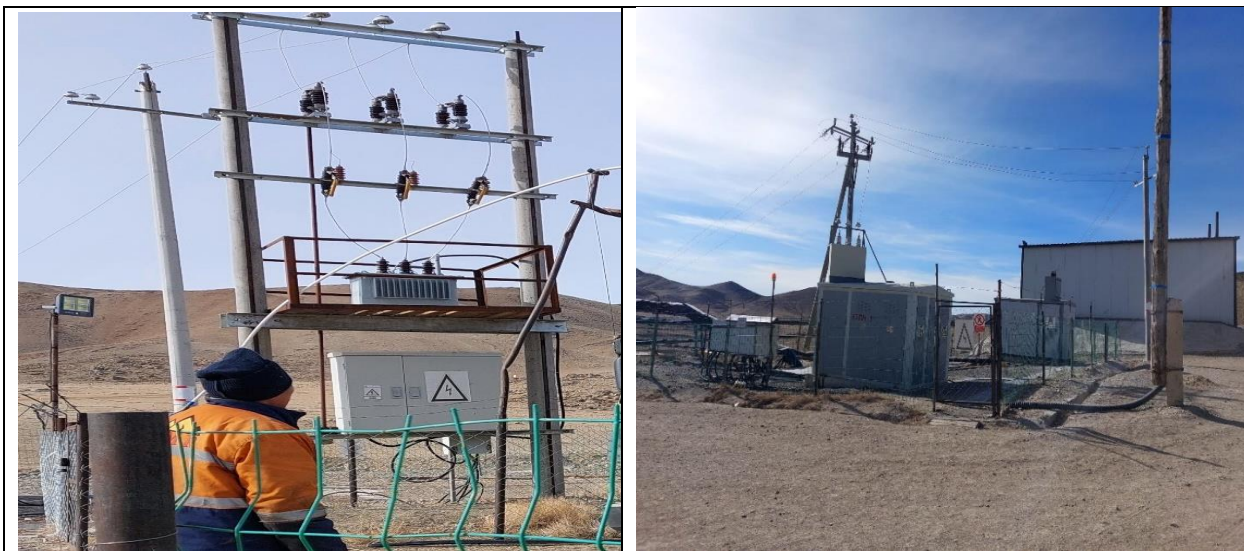
Зураг 19. Дэд станц
