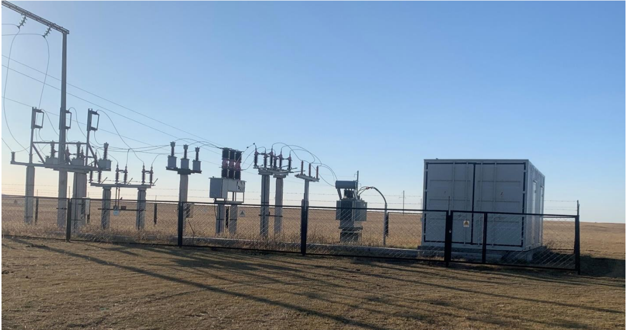
Зураг5. Дэд станц
