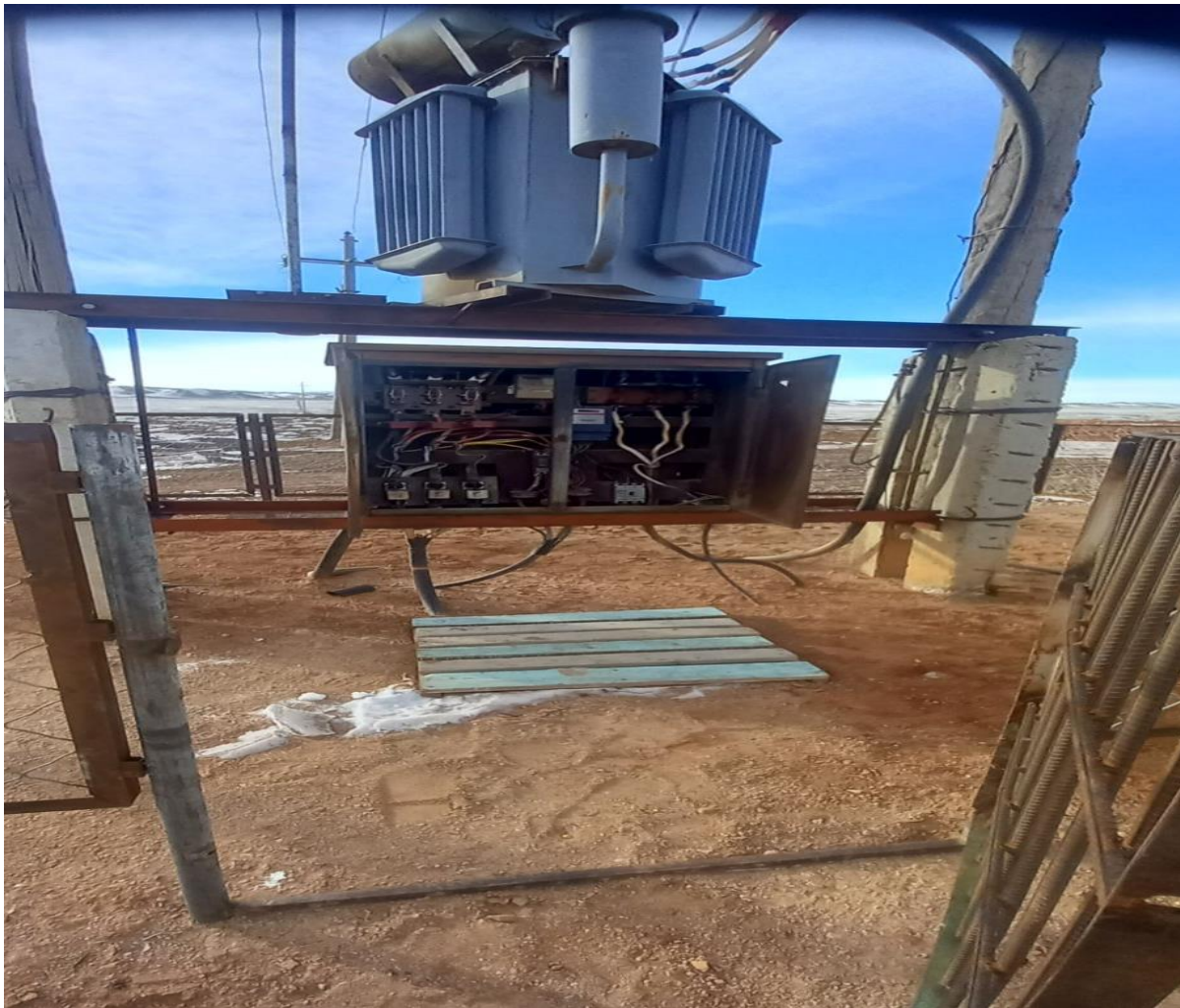
Зураг №. 2 Цахилгаан хангамжийн трансформатор
