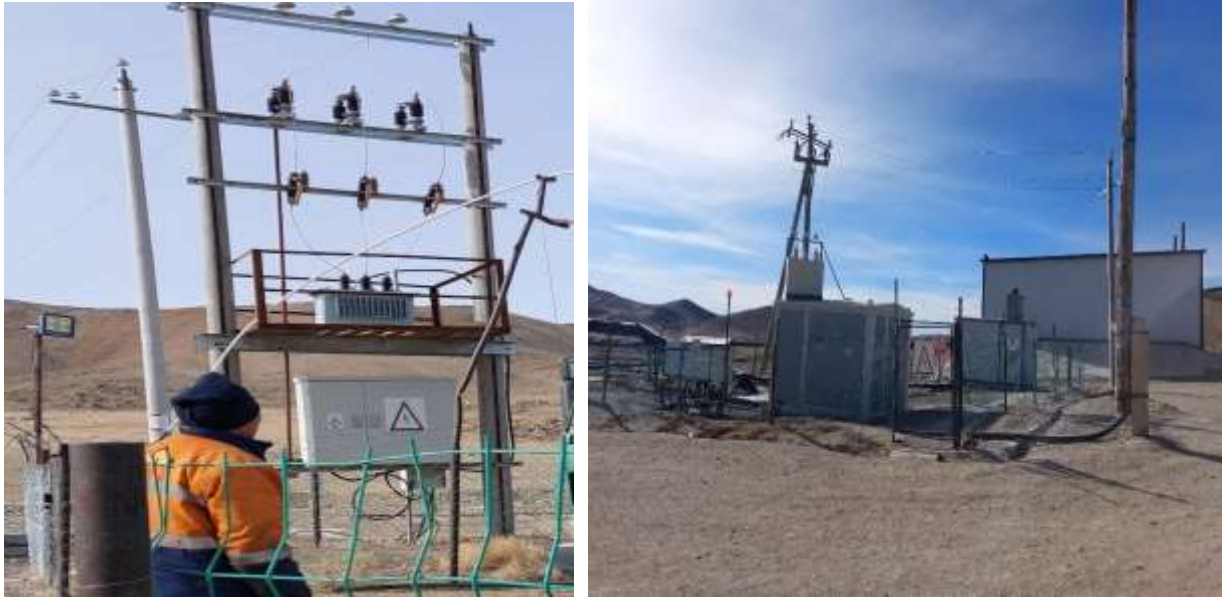
Зураг 14. Дэд станц
