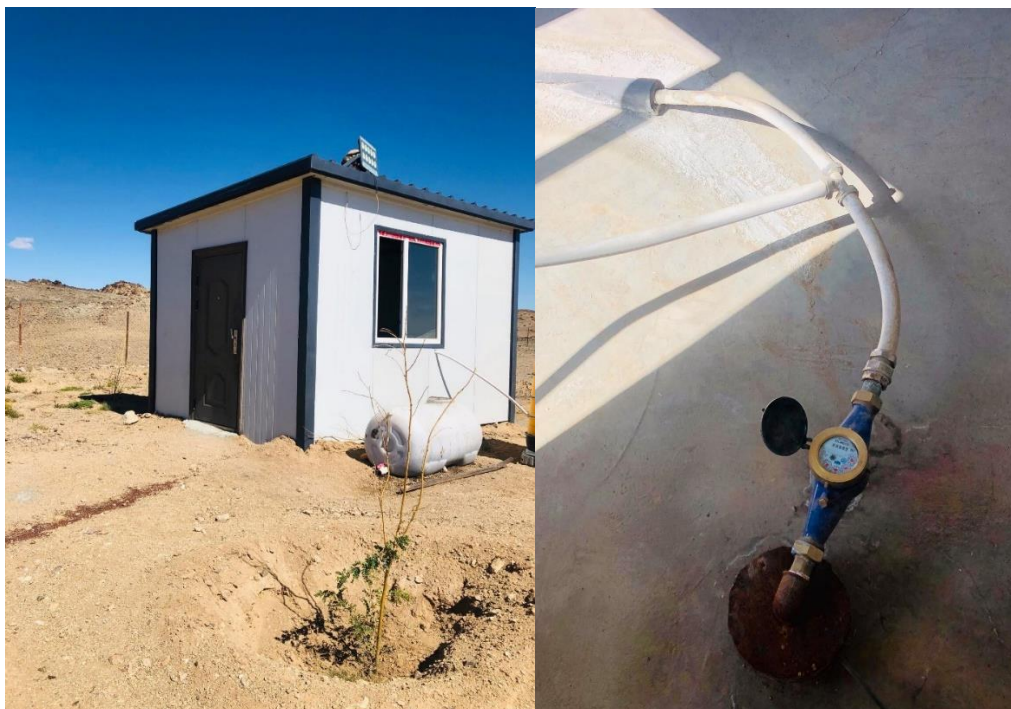
Зураг 11. Уурхайн хотхоны худаг, тоолуур суурилуулсан байдал
