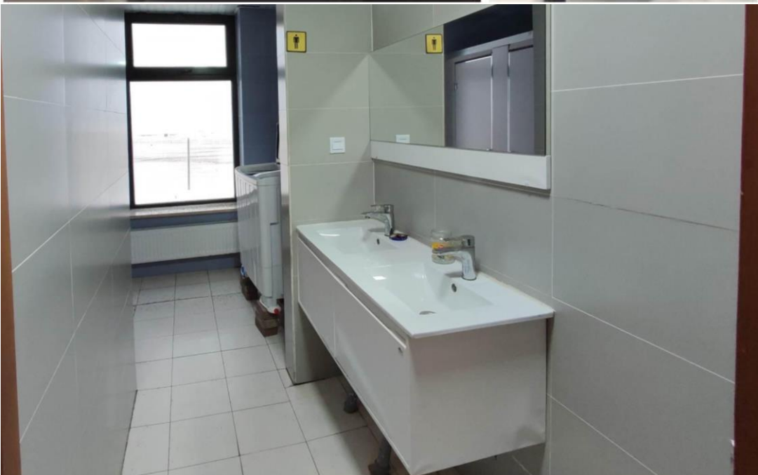
Зураг 17. Ариун цэврийн өрөөнд ус хэмнэдэг сантехникийн төхөөрөмжүүдийг суурилуулсан
