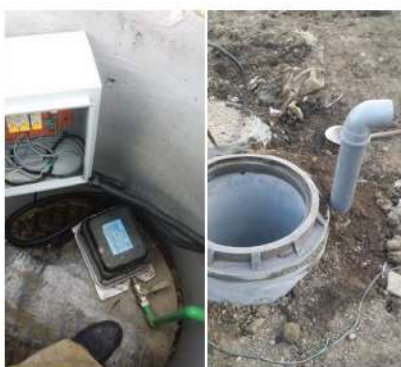
Тусгайлан агааржуулалттай худаг гаргаж агаарын шахуурга, цахилгааны самбар угсарч байрлуулсан. Агаарын шахуурга 120 л/мин хүчин чадалтай.
